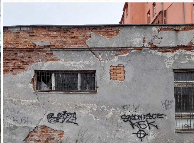
Zdjęcie nr 5. Widok attyki, rysy w okolicach nadproży
