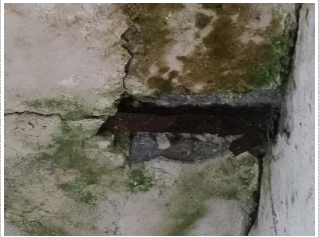
Zdjęcie nr 7. Widok attyki, rysy w okolicach nadproży
