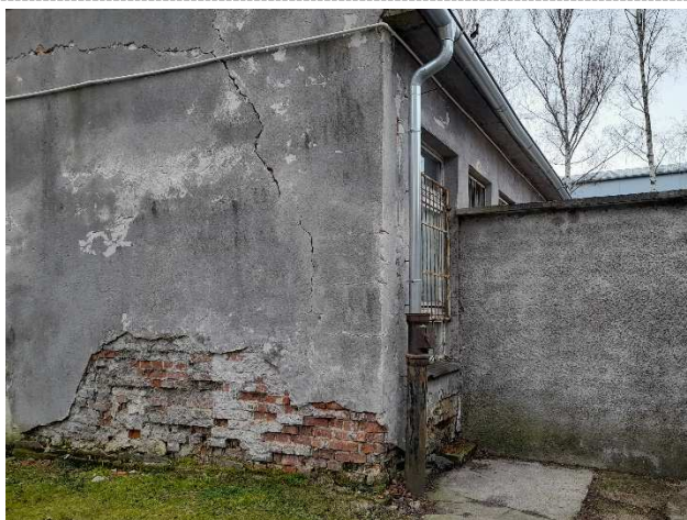
Zdjęcie nr 4. Ubytki tynku, zaprawy, pęknięcia ścian
