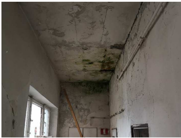
Zdjęcie nr 6. Przemoknięty strop
