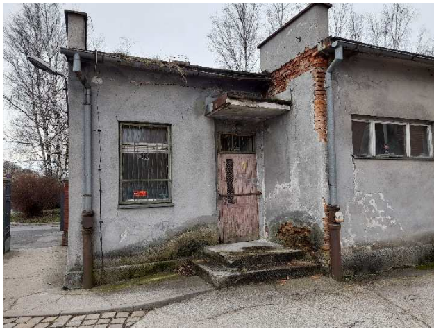
Zdjęcie nr 2. Zawilgocona część frontowa
